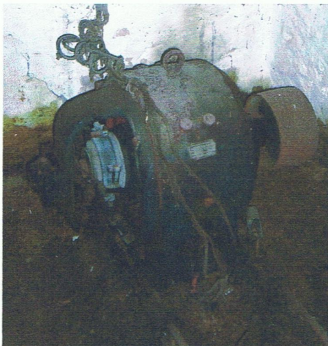
Her ses generatoren før vi afmonterer.
