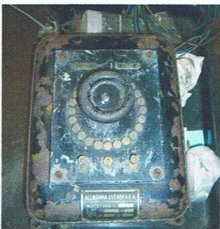
Den defekte regulator.
